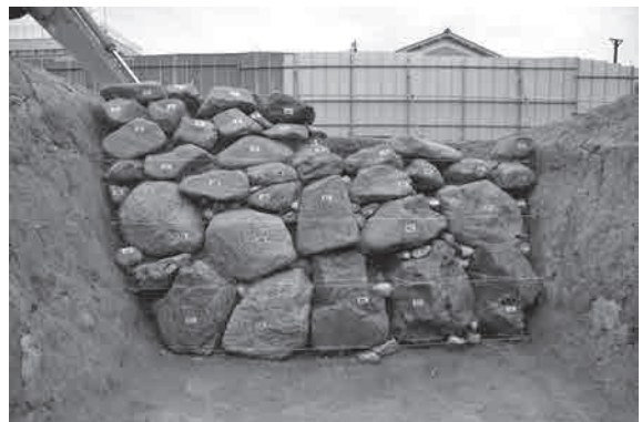
6. 石積み番付 移築保存のため石材に番号を付し、30cmごとのレベルラインを付して解体を行った。
