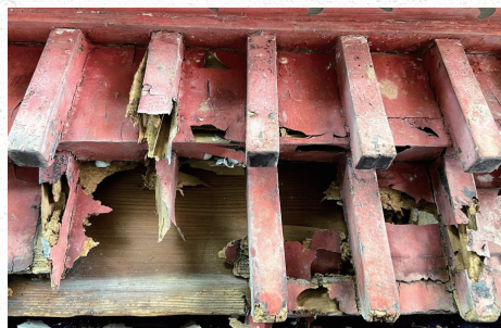
屋根裏の劣化状況
